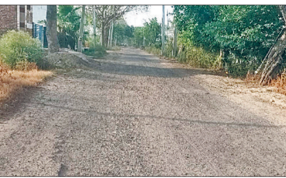
बीरबागड़ा जाने वाली जर्जर सड़क, जहां गड़बों से राहगीरों को हो रही परेशानी।
